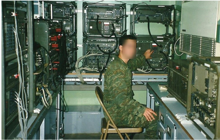
Εσωτερικό κλωβού του Συστήματος «ΑΠΟΛΛΩΝ»
